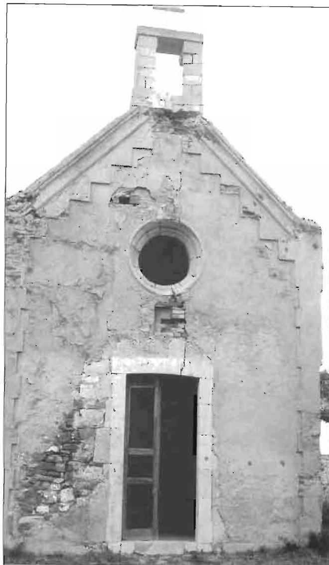
Año 1986 Estado de la fachada de Santa Catalina. Encima del dintel de la puerta se ve el hueco donde estaba alojado el escudo del apellido Lersundi. (Foto P. Aldabaldeirecu)
